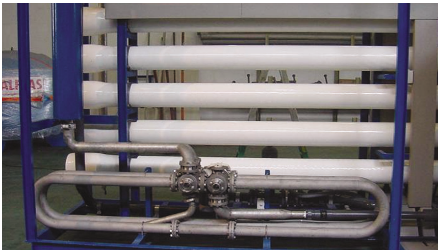
R.O. Kinetic acoplado a un bastidor de ósmosis inversa
