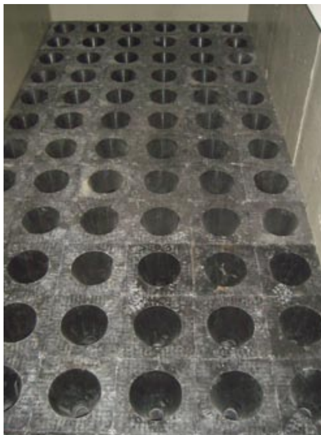
Piso dosificador de calcita instalado
