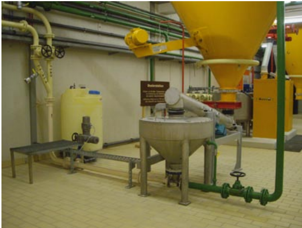
Sistema de dosificación de calcita granulada por arrastre por agua
