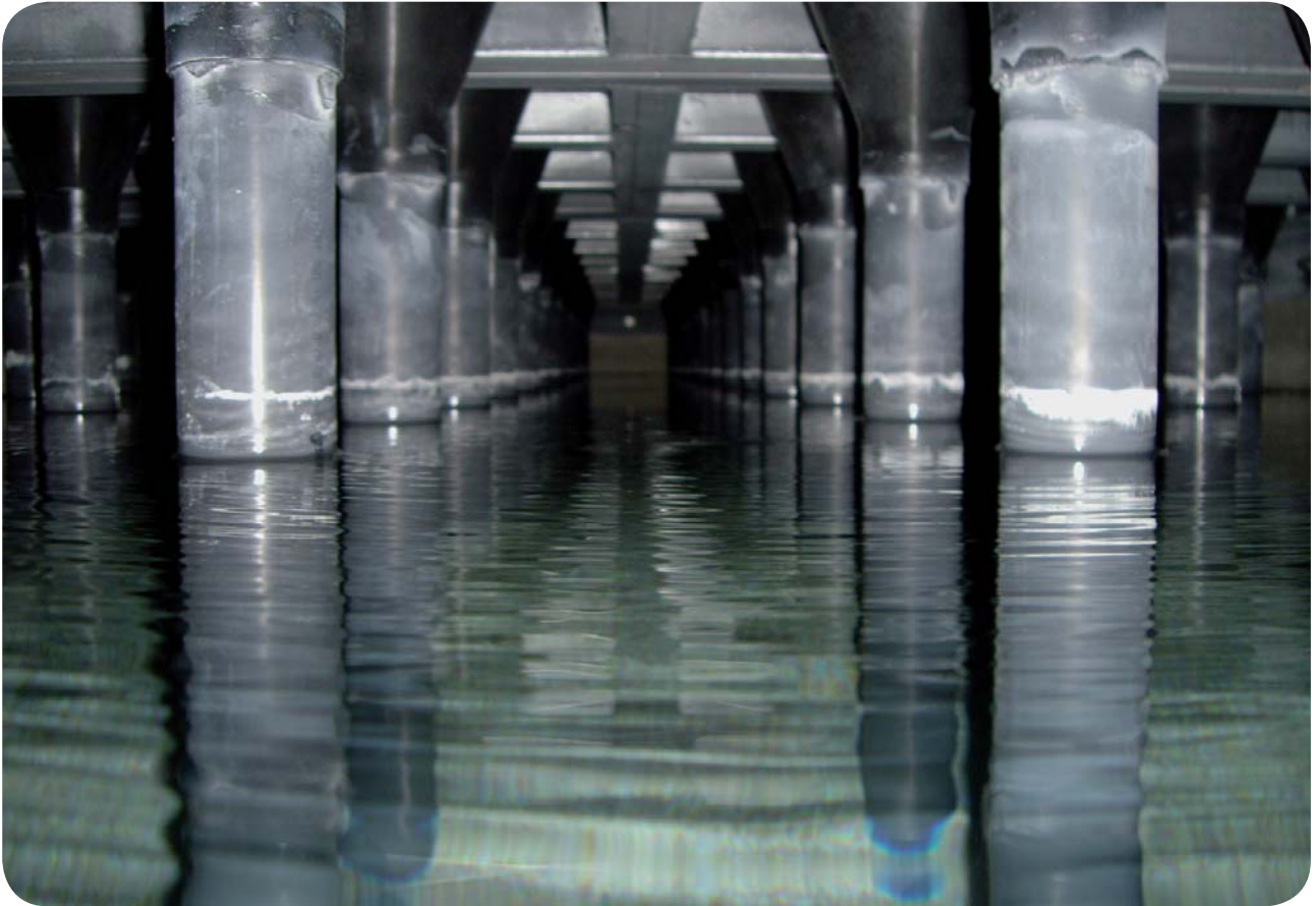
Fig. 1: Sistema de dosificación en continuo de los lechos de calcita en funcionamiento normal. (Foto cortesía de Inima-OHL)
