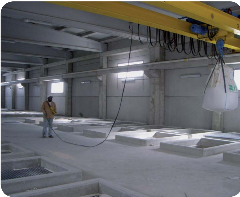
Fig. 2: Carga de los silos de calcita con big bags.(Foto cortesía de Inima-OHL)
