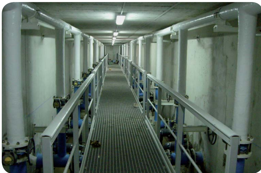
Fig. 5: Sistema de alimentación de agua y aire de las celdas de la IDAM Alicante II. (Foto cortesía de Inima-OHL)
