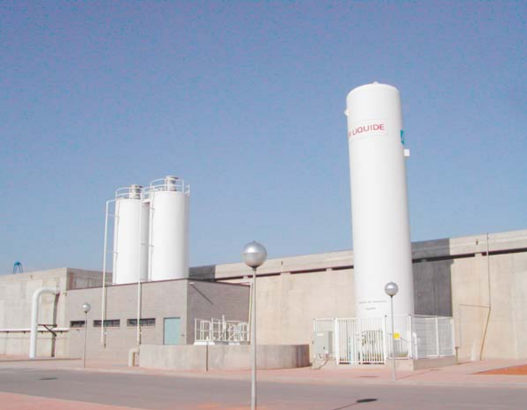
Planta de tratamiento con \text{Ca}(\text{OH})_2 y \text{CO}_2 (Almería 50 MLD) UTE Acciona Agua-Abengoa
