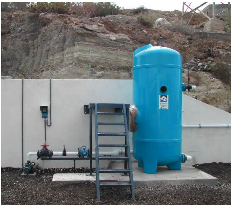
Prototipo de 420 m 3 /d instalado en la desaladora de Adeje-Arona (Tenerife)
