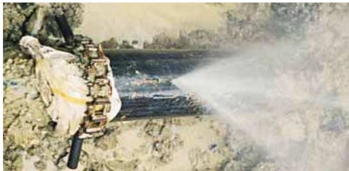
Foto 1. Pequeña fuga en tubería de hierro fundido
