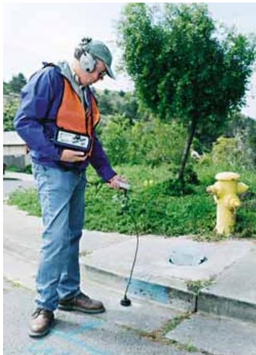
Foto 3: Localización de una fuga sobre la línea de una boca de riego
